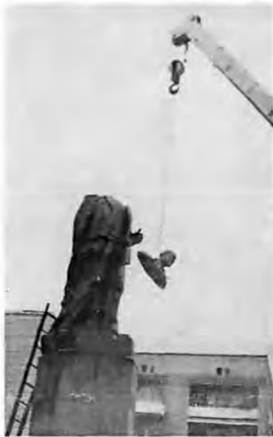
Демонтаж пам'ятника Ленінові в Городенці.
